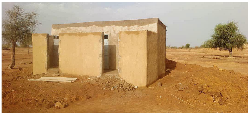
Le bloc sanitaire construit selon les normes environnementales en vigueur au Burkina Faso
